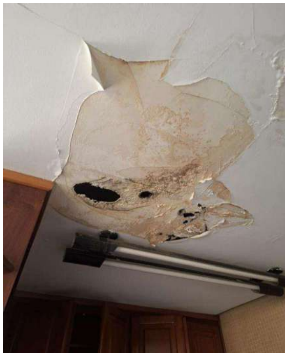
Foto 23 - Teto Salão Cobertura
