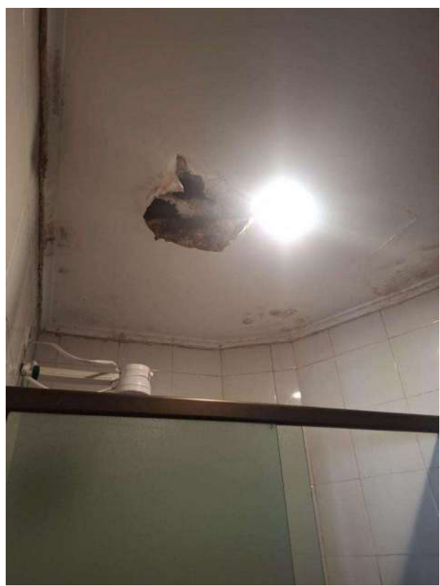
Foto 26 - Teto Banheiro Cobertura
