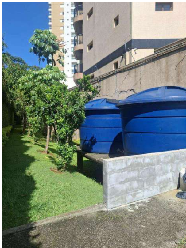
Foto 79 - Caixas de Água
