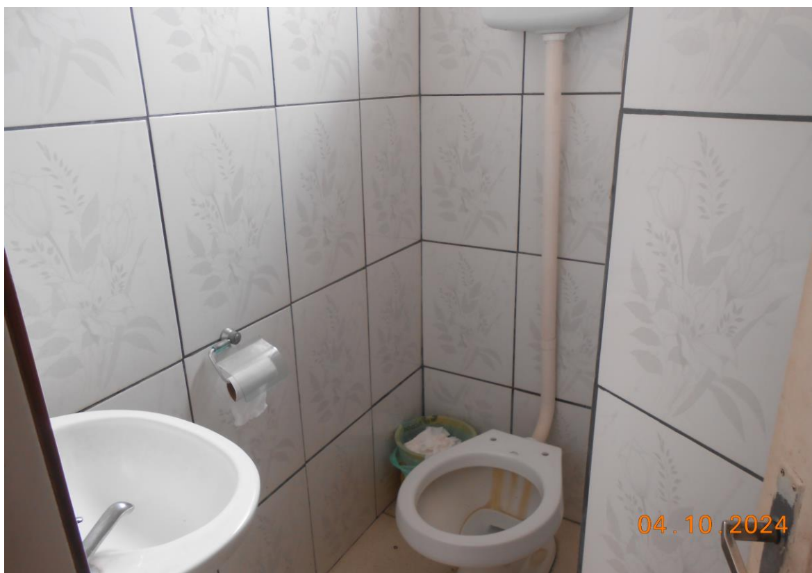
Foto 3: Vista de um dos wc do imóvel de matrícula nº. 8533.
