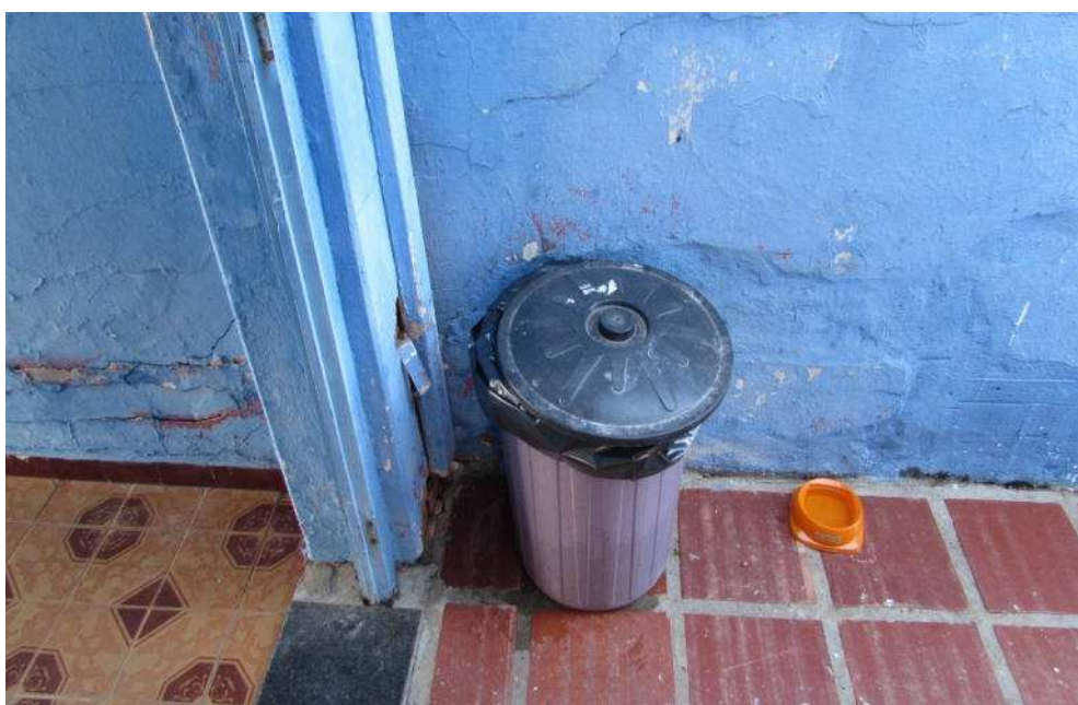
Corredor externo com trincas e fissuras
