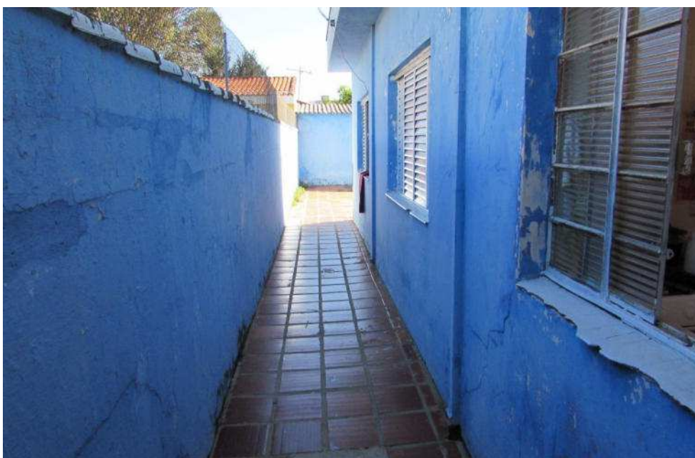
Corredor externo com trincas e fissuras
