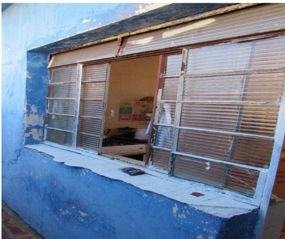
Parte externa da cozinha com ajulejos danificados, esquadria em péssimo estado
