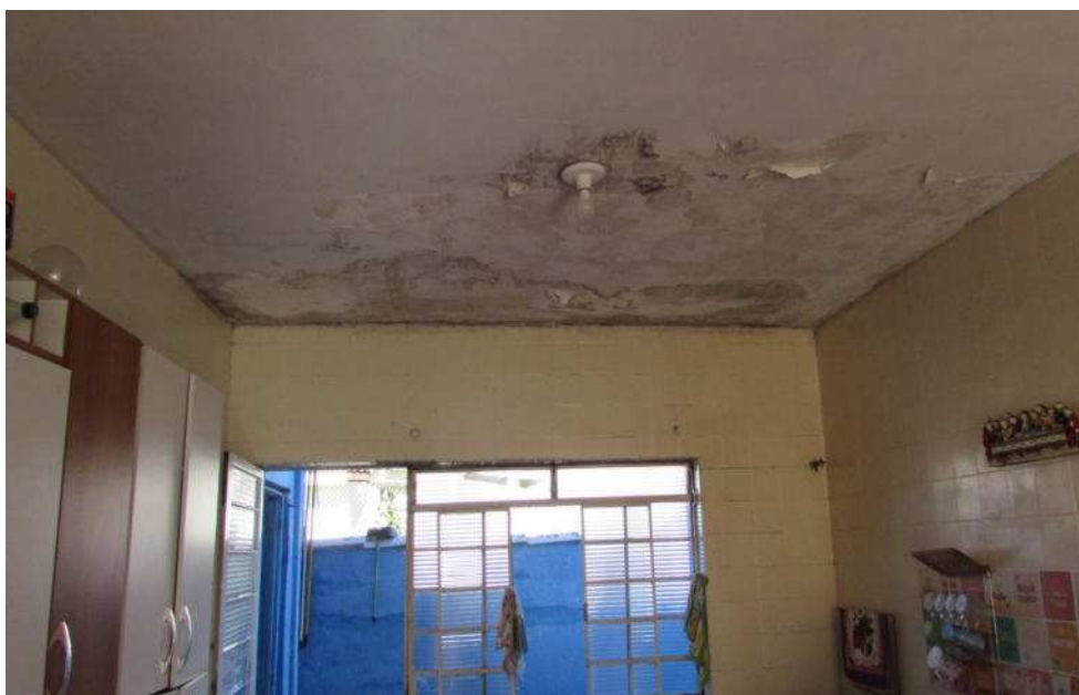
Cozinha com pintura em péssimo estado
