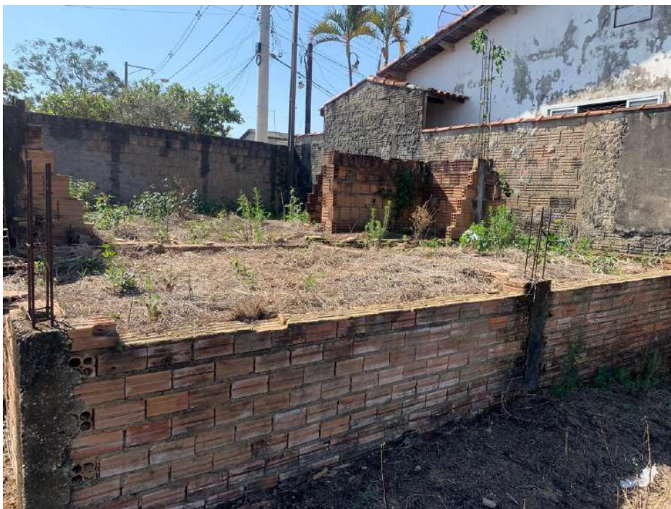
Foto 07 – Vista da construção inacabada – Aterro – Nível do piso – Sem sinal de impermeabilização correta da parede aterrada - Sem valor agregado – Ônus de demolição e retirada.
