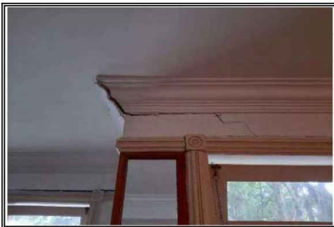
Foto nº 31: Detalhe de trinca do forro do banheiro feminino
