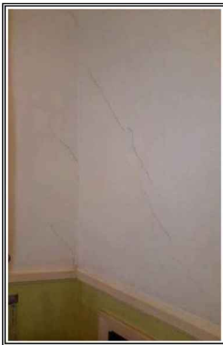
Foto nº 34: Detalhe de trincas na parede do banheiro masculino
