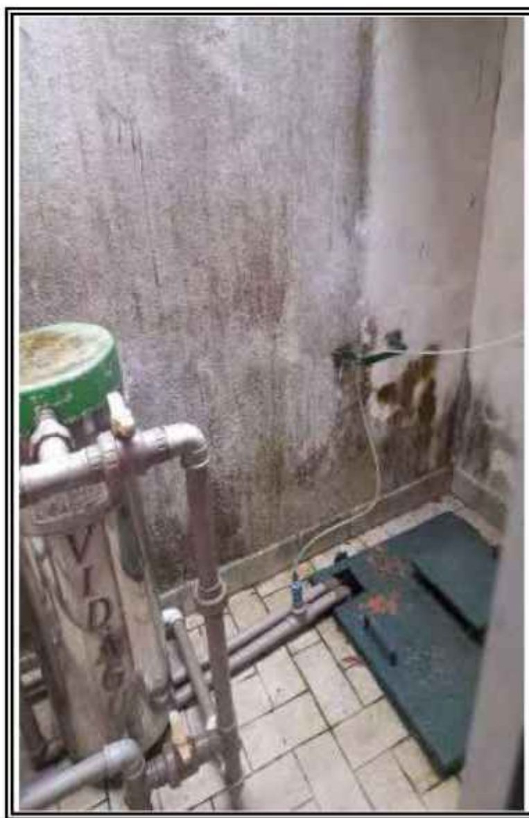
Foto nº 58: Detalhe de poço artesiano na lavanderia
