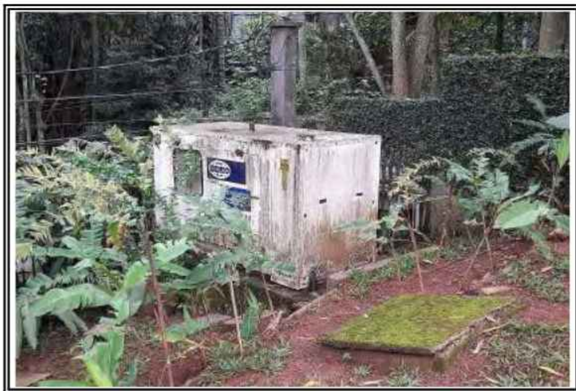
Foto nº59: Vista de parte da área externa com detalhe do gerador de energia (desativado)
