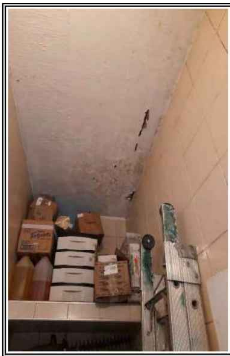
Foto nº 61: Detalhe de infiltrações e trincas no forro do dormitório de apoio
