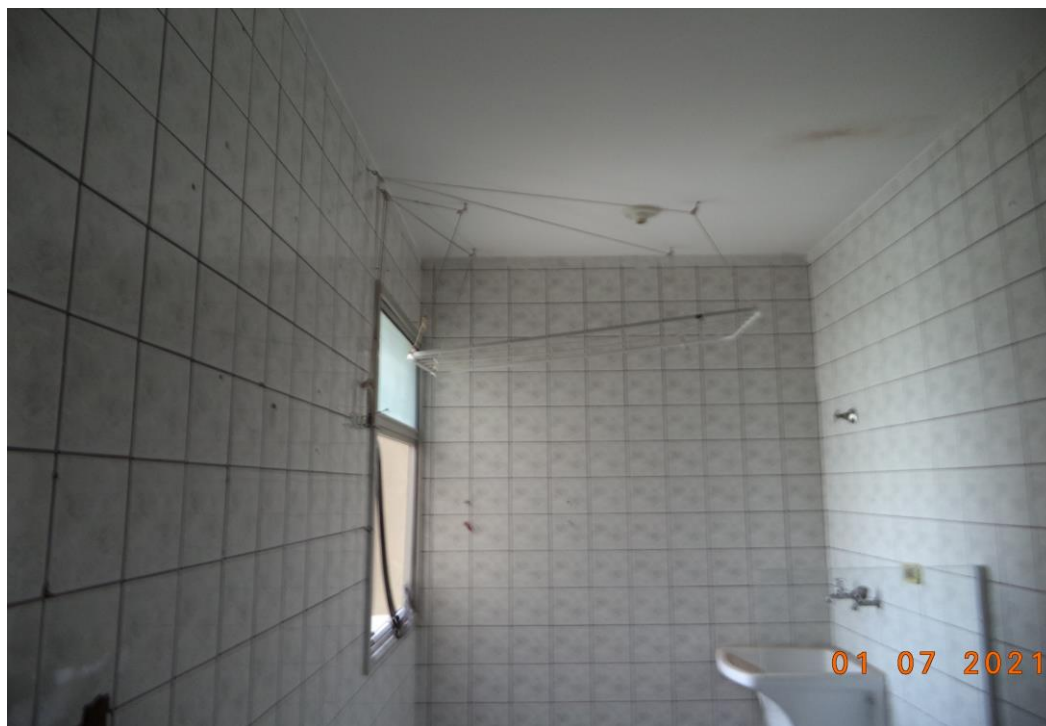
Foto 36 - Lavanderia, vidro da janela quebrado e até a data da vistoria estava sem vidro
