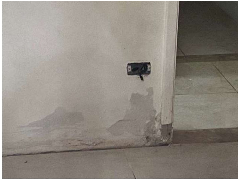
Foto 7 – Detalhe para ausência de tomada, tinta descascado e ausência de rodapé. Imagem obtida pela área externa do térreo.
