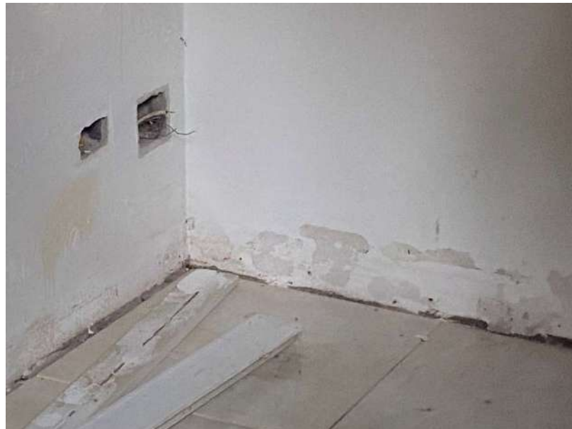
Foto 8 – Detalhe para ausência de tomada, tinta descascado e ausência de rodapé. Imagem obtida pela área externa do térreo.
