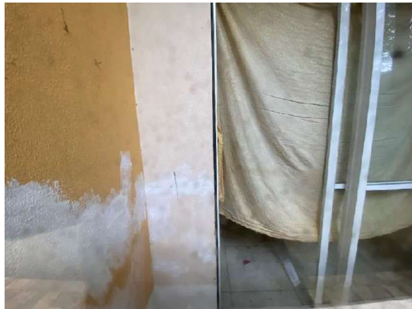
Foto 10 – Vista da sacada do imóvel avaliando. Detalhe para marcas de reparo sem pintura. Imagem obtida pela área externa do térreo.
