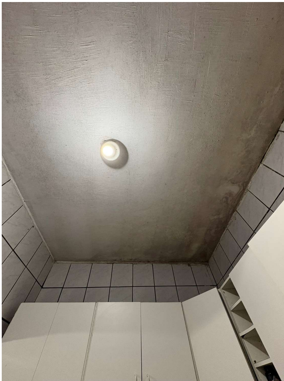
Figura 12: teto da cozinha irregular
