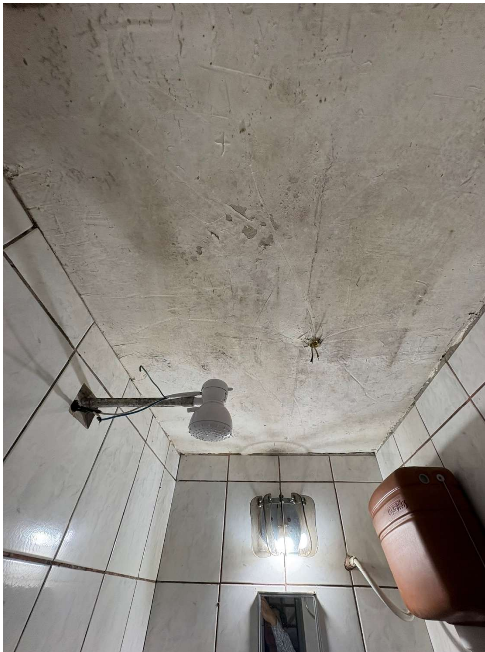
Figura 30: banheiro - teto irregular
