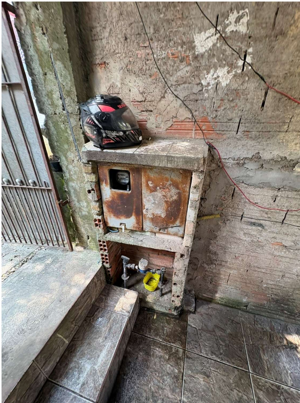
Figura 7: quadro de energia e relógio de água
