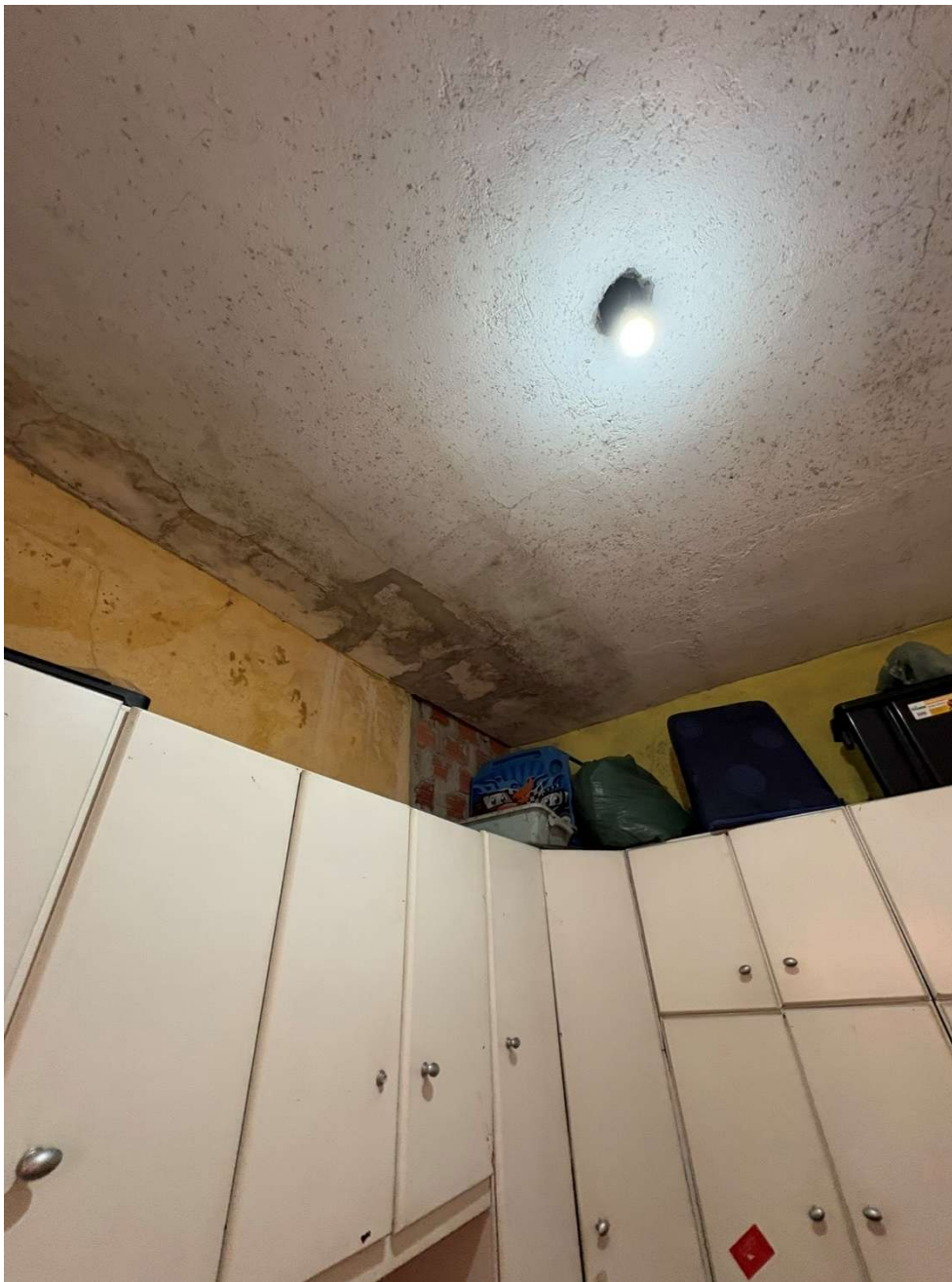
Figura 23: dormitório 2 - teto e parede irregular
