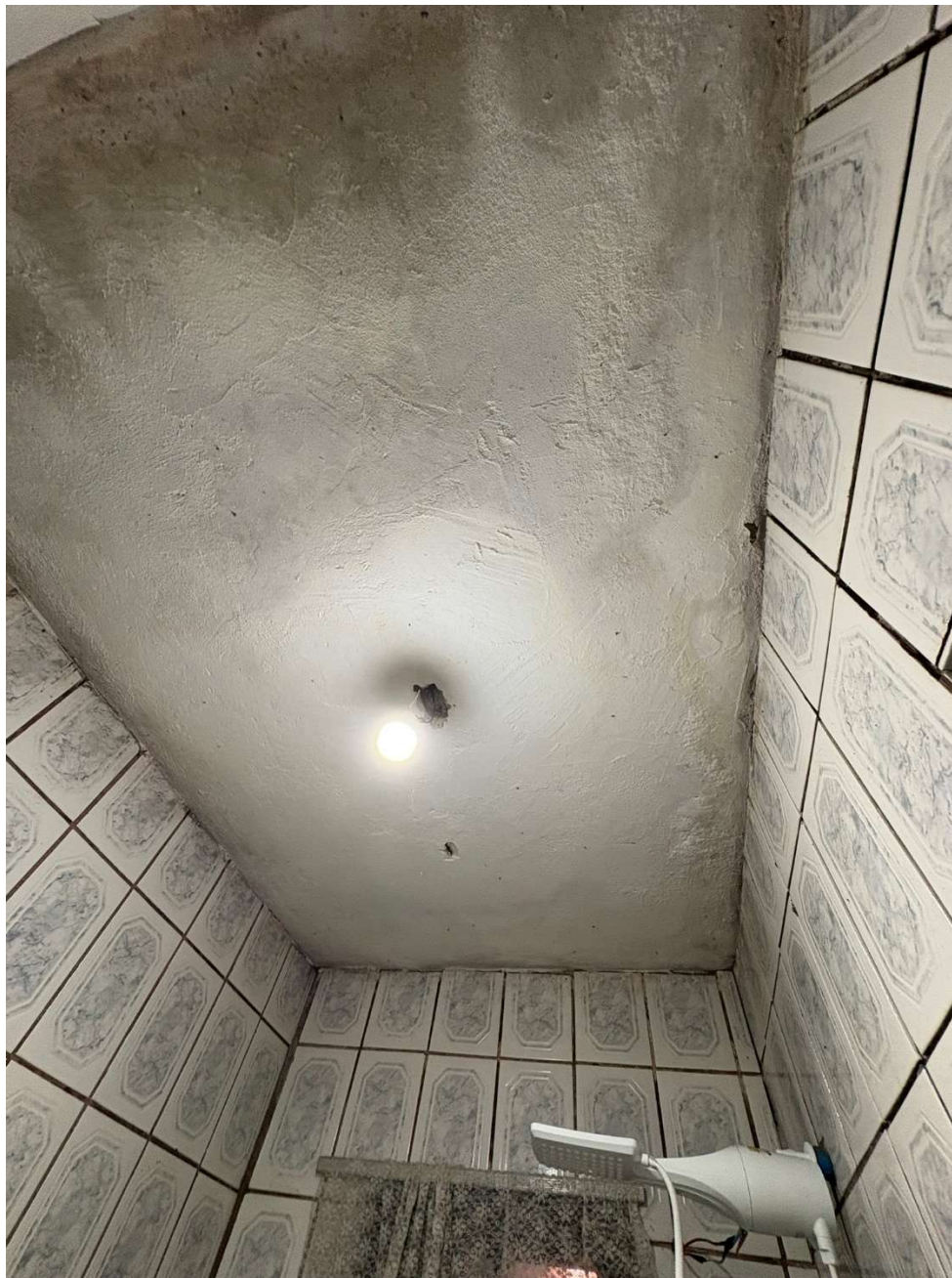
Figura 14: banheiro - teto irregular
