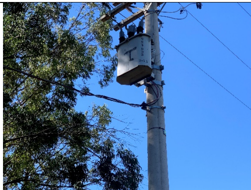
Foto 04. Vista do transformador de energia elétrica
