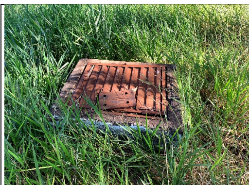
Foto 11. Vista do acesso ao poço artesiano
