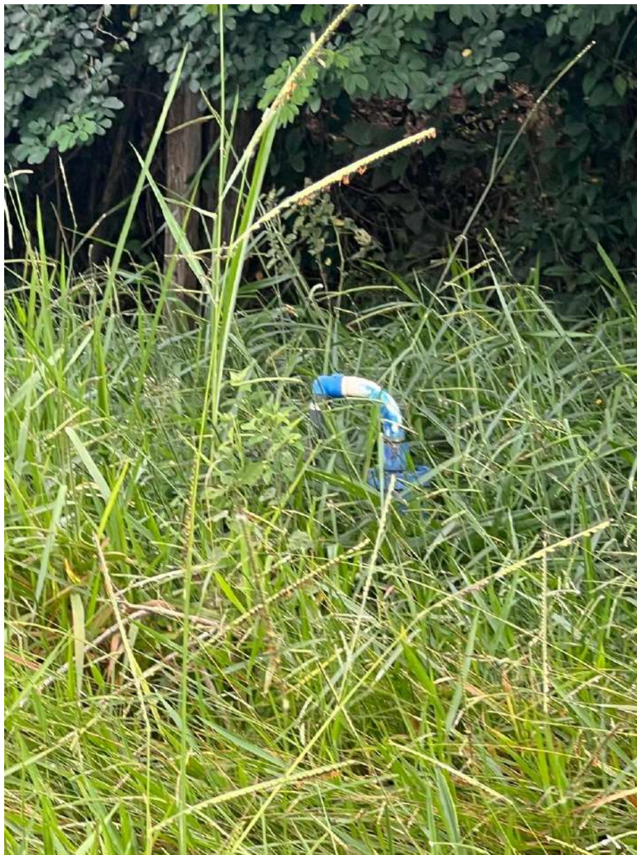
Foto autoral tubulação de interligação reservatório/subterrânea obtida em 27/04/2026
