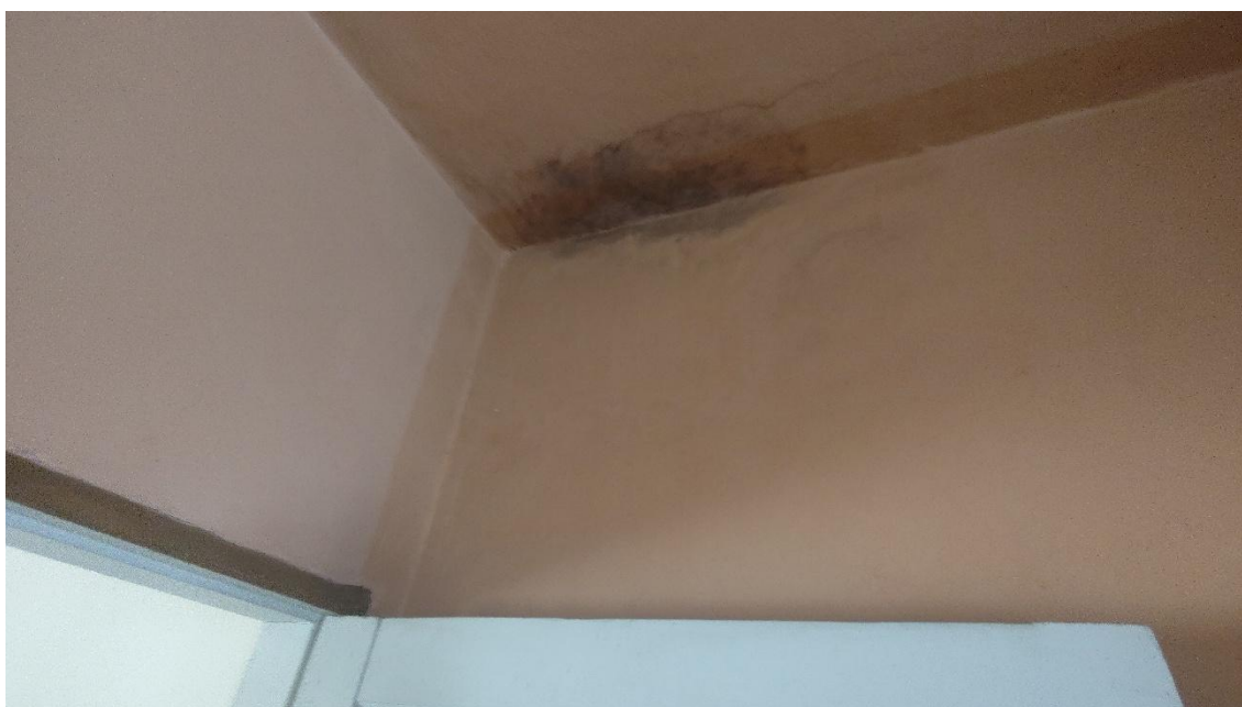
Sinais de umidade
