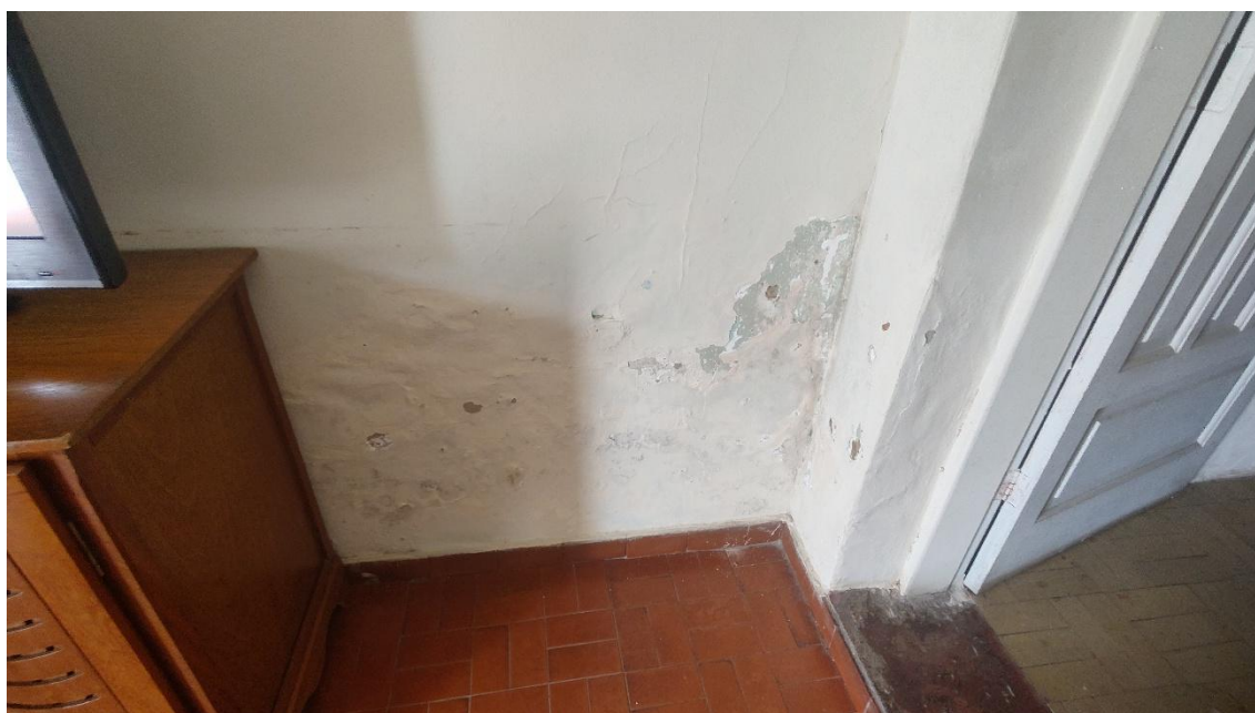
Sinais de umidade
