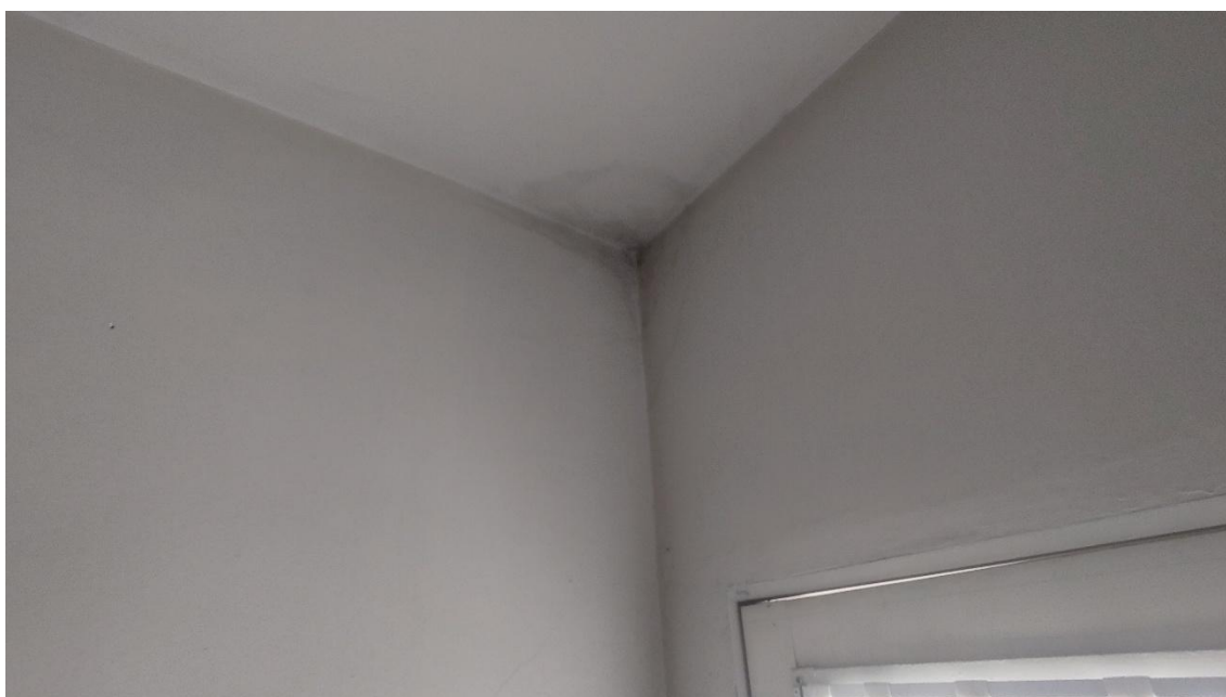
Sinais de umidade
