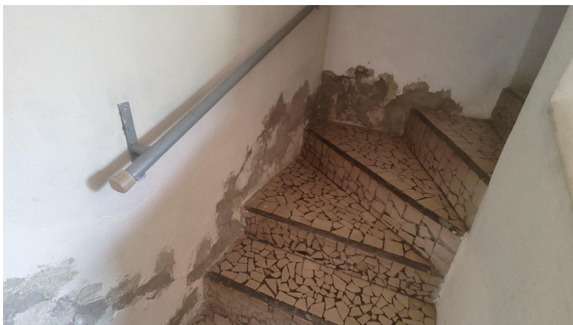
Sinais de umidade
