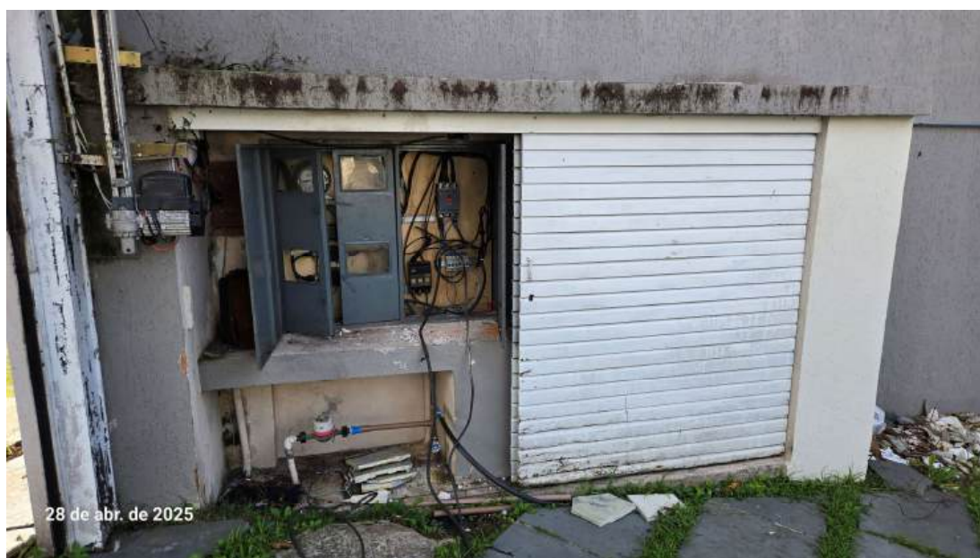
FOTO 11: Cavaletes de energia elétrica e de água.
