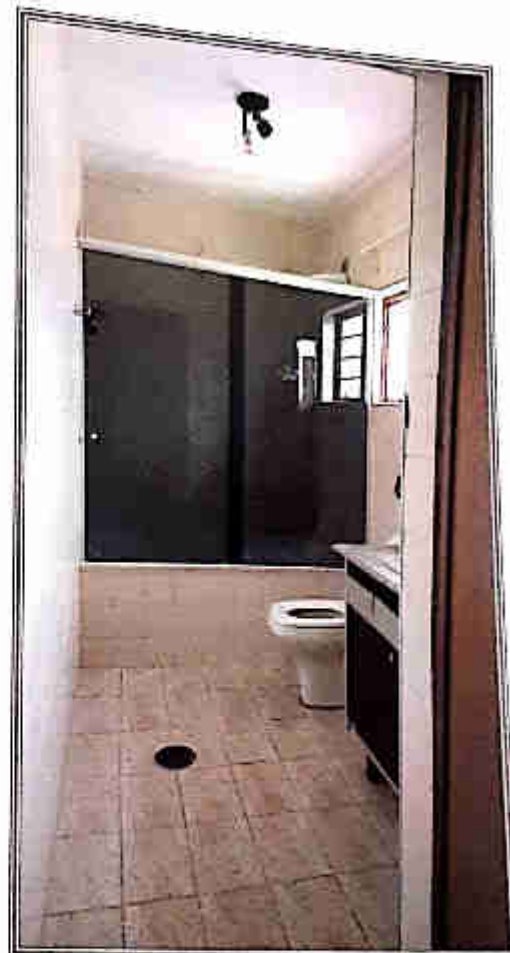
Comentário (♦): Vista genérica do banheiro do consultório 1. O piso e as paredes são revestidos por peças cerâmicas.
