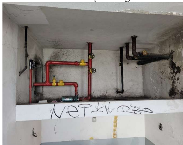
06 sistema de distribuição de água
